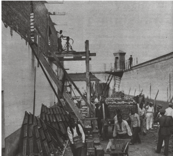
Imagen 5. Realización de obras de reforma en la Casa de Trabajo de Alcalá de Henares por parte de individuos incurso en la Ley de Vagos y Maleantes
